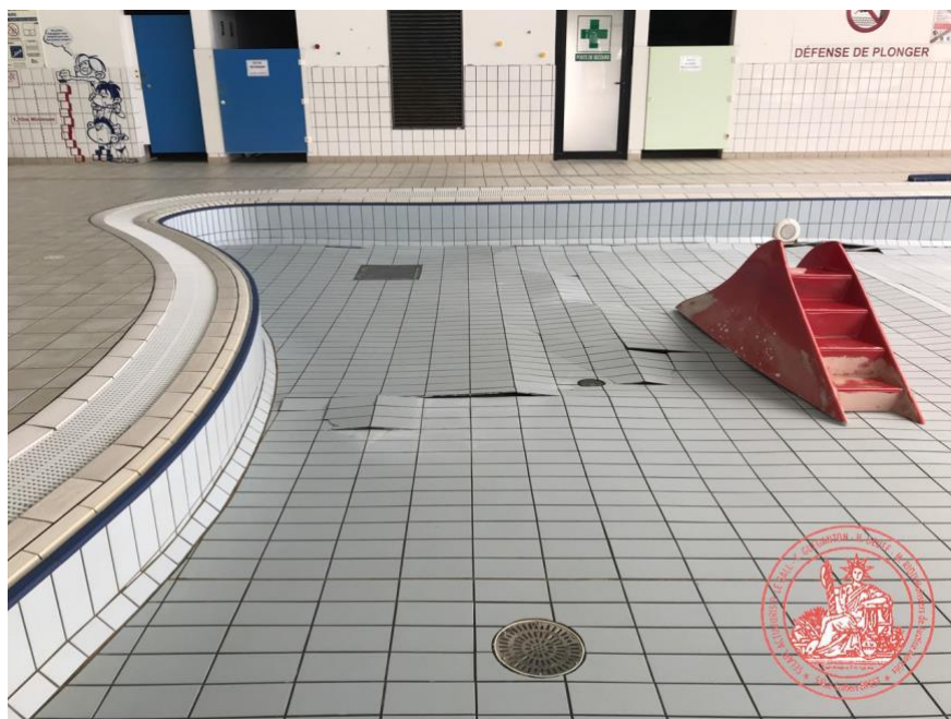
Figure 7 – Dommages sur les carrelages de fonds de bassin au Spadium de parc de le Relecq-Kerhuon.
